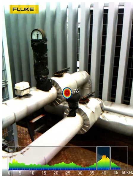
Détection de fuite sur un pipeline
